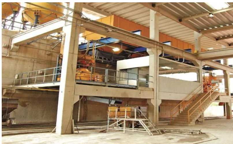
Central de concreto
